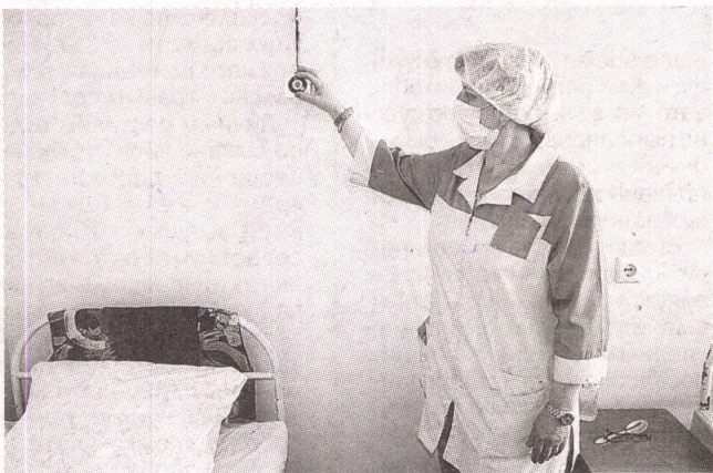
Кислородопровод подведен во все палаты главного корпуса.
